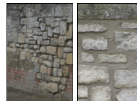
Réfection du mur d'enceinte de l'église de Prouvais : déjointement et rejointement, taille et remplacement de pierres suite à une formation délivrée par le GRETA.
